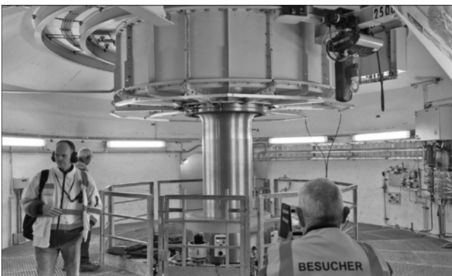
Rotorwelle mit Turbine, Pumpenrad und Generator – insgesamt 330 Tonnen schwer
