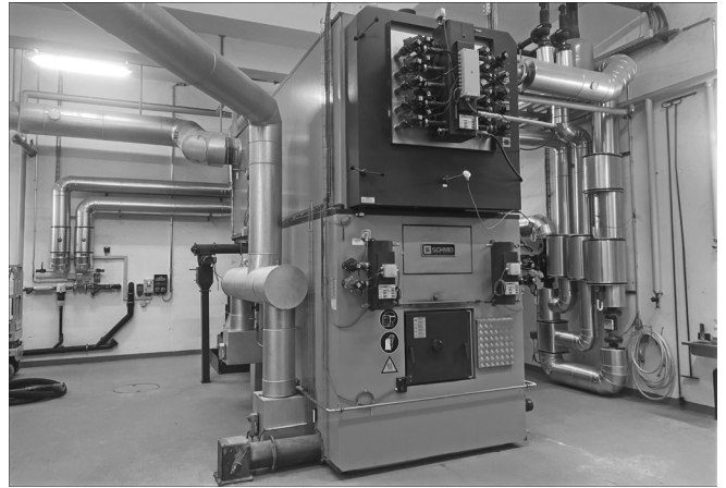
Waldhackschnitzel-Feurofen für das Fernwärmenetz Rheinfelden Ost mit 1.6 MW Leistung
