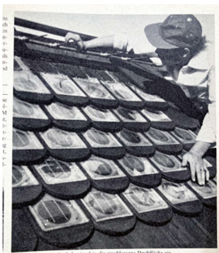
...die Solarzettel in die geschlossene Dachfläche ein.
