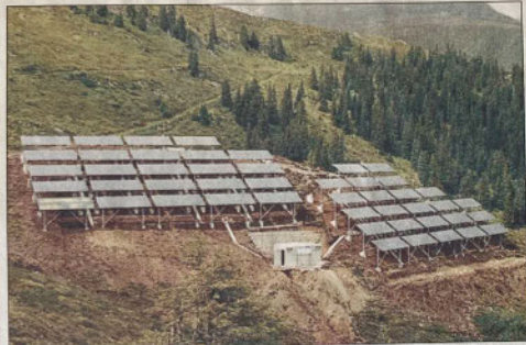
Die Solaranlage ob Disentis hat eine Leistung von 100 Kilowatt. (Bild NOK)
