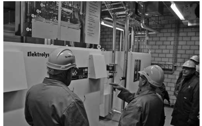
Der Elektrolyseur erzeugt mit Strom Wasserstoff und Sauerstoff
