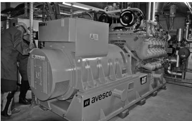
Das Blockheizkraftwerk produziert aus Gas Strom und Wärme
