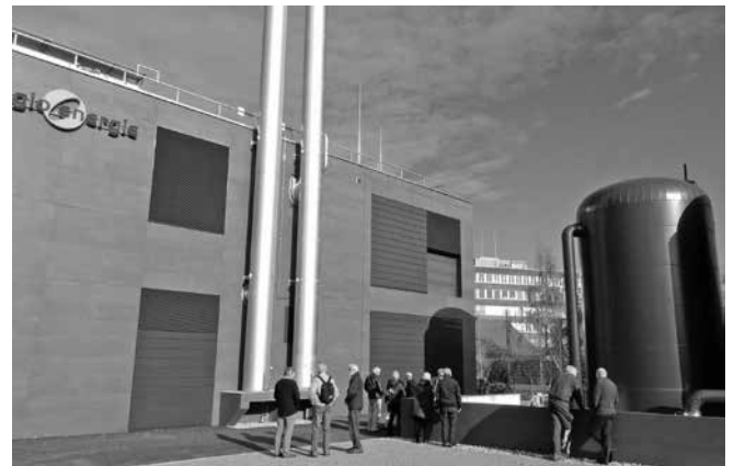
Warmwasserspeicher beim Hybridwerk
